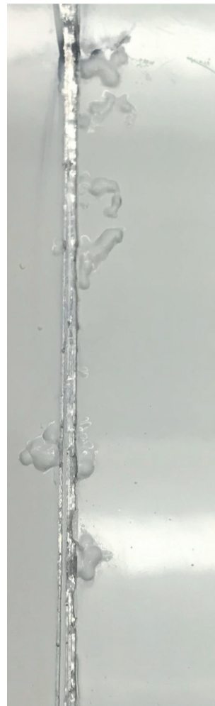
Das Bauteil weist unzureichenden Korrosionsschutz auf.
